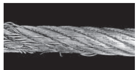
Zu weite Seilrillen unterstützen die Seile schlecht. Die Folge sind frühzeitige Drahtbrüche entlang einer Laufspur.
